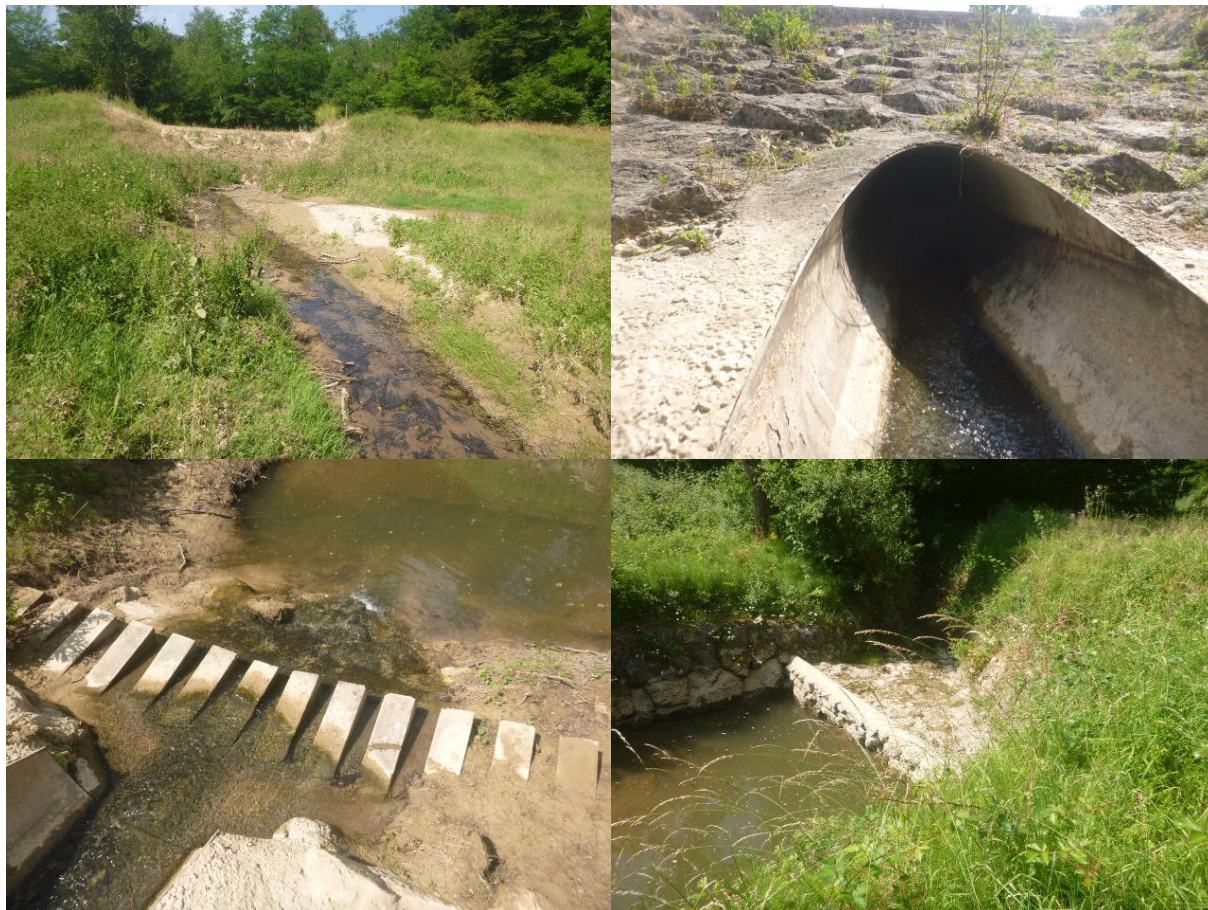
Photo 8 : Ouvrages hydrauliques du bassin de Paillet (SEGI, 2020)
