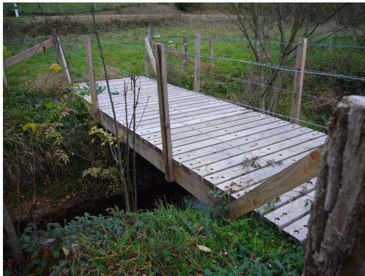
Photo 3 : Passerelle à bétail
