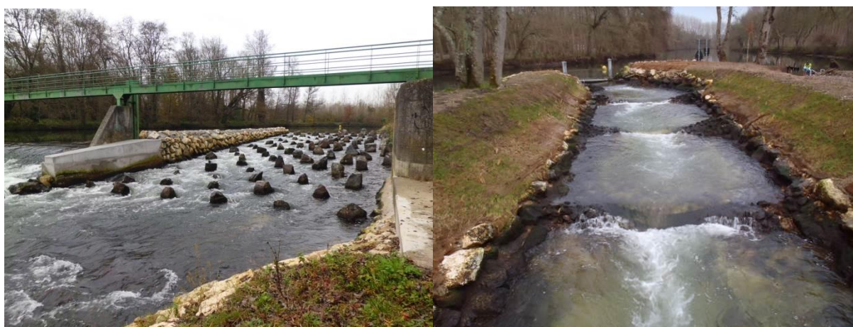
Photo 6 : Vue d'une rampe en enrochements régulièrement répartis et d'un bras de contournement avec seuils triangulaires (SEGI)
